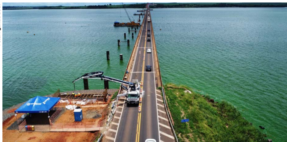
A duplicação da maior ponte de São Paulo também exige operação sobre o Rio Tietê, com balsas, embarcações de apoio e fundações dentro do rio
